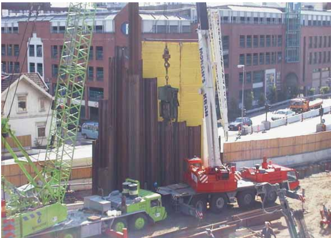
Figur 18.4 Støyskjermende tilta E 18 Kristiansand, Banehagen tunnelportal
