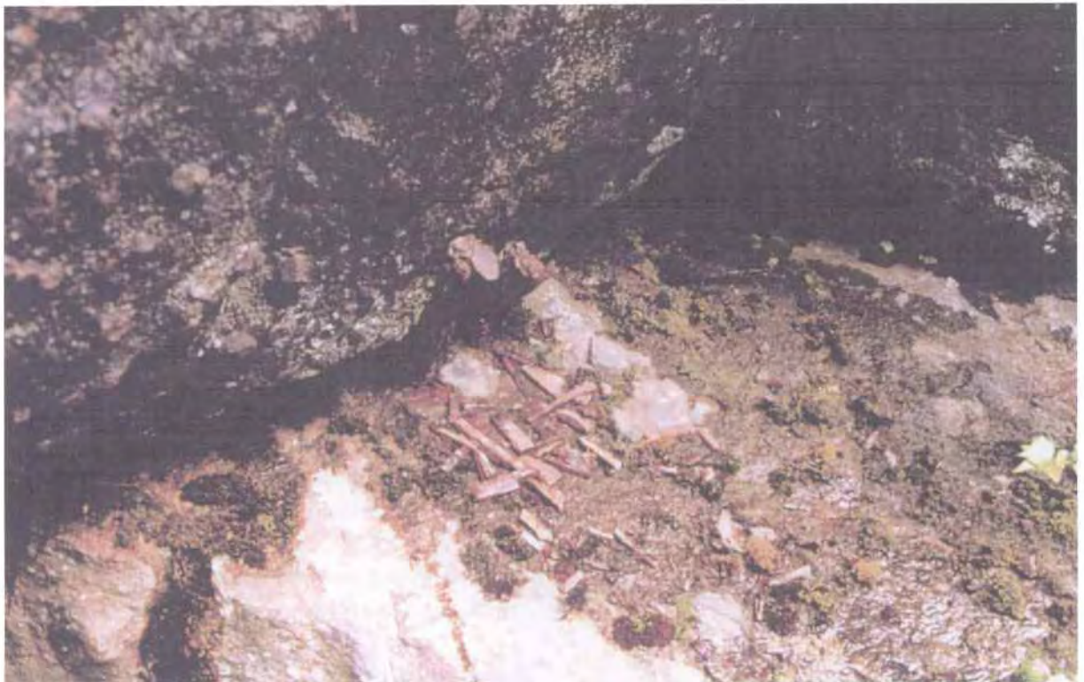
Korrosjon på 50 år gamle svartstålbolter. (Foto: K. B. Pedersen)
